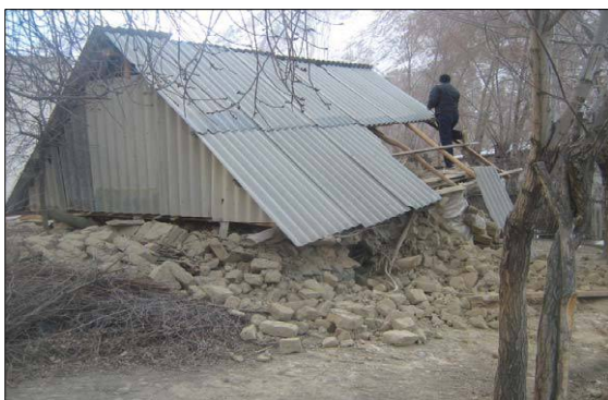
Разрушенный дом в Вандже | Общество Красного Креста в Таджикистане
